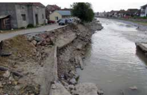
Poničená koryta řek jsou po povodních častý jev.
