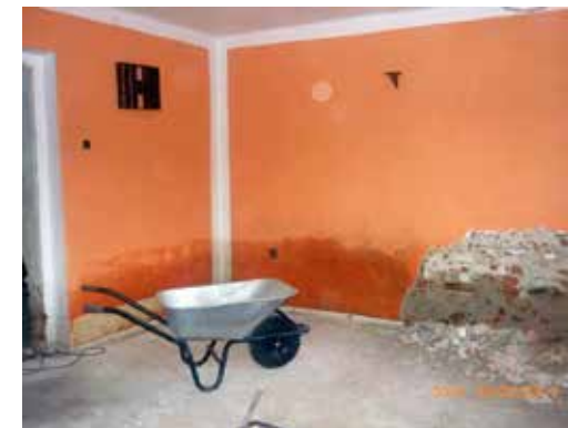
Pokud je omítka kontaminovaná znečištěnou vodou nebo odpadává, odstraňte ji do výše cca 20cm nad úroveň zatopení.
