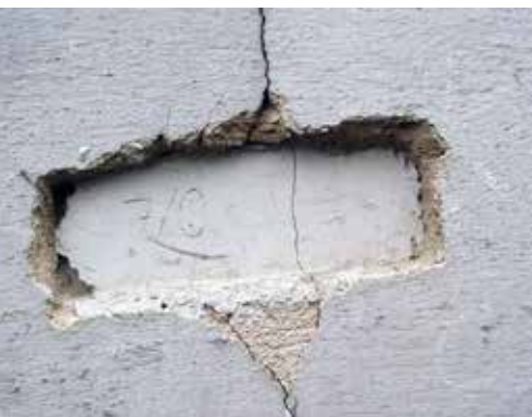
U prasklin odstraněte na několika místech omítku a překryjte je sádrovou destičkou. Porušený sádrový terč pak indikuje pohyb konstrukce a je potřeba zavolat statika, ať odborně posoudí bezpečnost domu.
