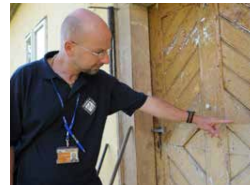
zjišťují míru zaplavení a poškození domácnosti,
