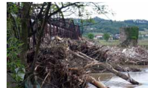
Zachycené dřevo na mostě působí jako překážka a může lokálně zhoršit povodeň.
