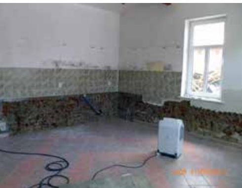
Při použití vysoušečů je potřeba mít zavřená okna.
