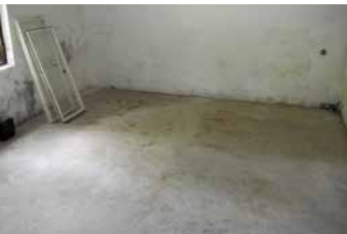
Škody v prázdném bytě jsou výrazně nižší.
