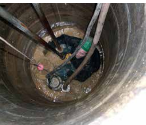
Studnu čistěte vždy za pomoci dalších osob.
