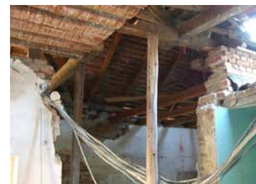
Narušené konstrukce zajistěte alespoň provizorně proti dalšímu poškození.
