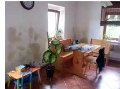
Uspěchaní oprav a předčasné zabydlení vede k vystoupení vlhkosti ze zdiva na opravený povrch.
