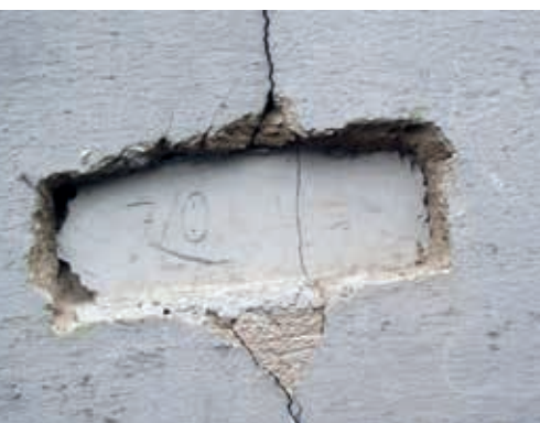
U prasklin odstraňte na několika místech omítku a překryjte je sádrovou destičkou. Porušený sádrový terč pak indikuje pohyb konstrukce a je potřeba zavolat statika, ať odborně posoudí bezpečnost domu.
