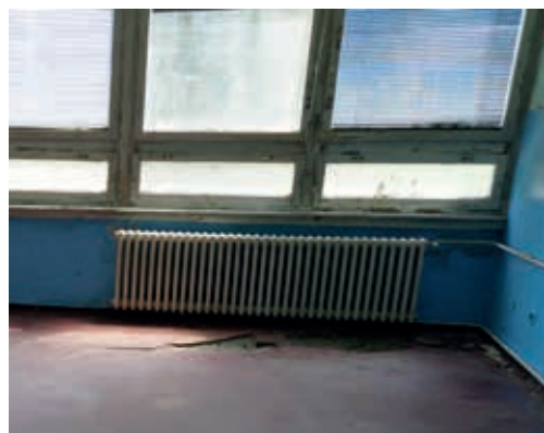
Popraskání podlahy vzlakem vody při zaplavování.
