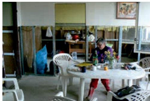
U nepřipravené domácnosti mohou být škody po povodních v řádu statisiců.
