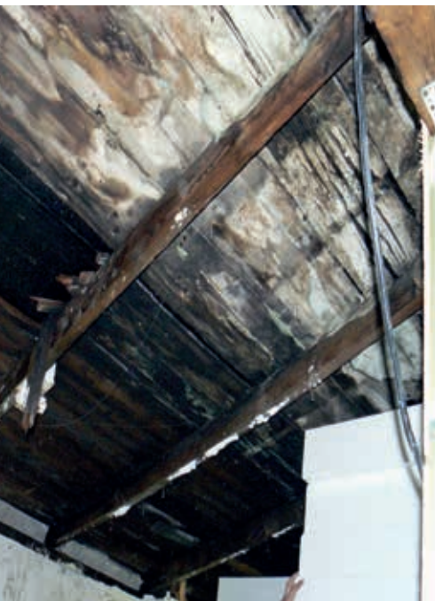
Dřevěné konstrukce ponechané ve vlhku velmi rychle podléhají zkáze hnilobou.
