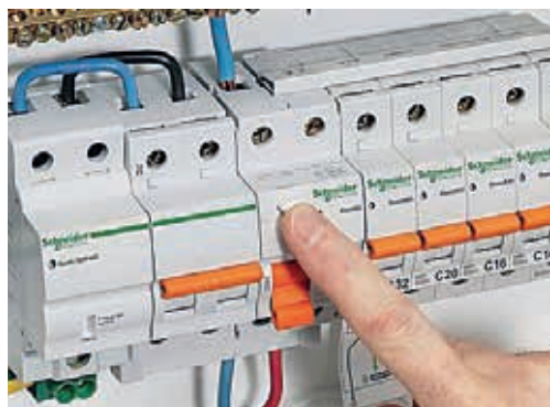
Před opuštěním bytu vypněte pojistky, uhasťte otevřený oheň ve spotřebičích a uzavřete hlavní přívody vody a plynu. V přízemí a suterénu utěsněte toaletní mísy, kvůli zpětnému vzduči vody v kanalizaci.
