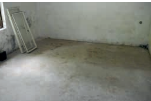
Škody v prázdném bytě jsou výrazně nižší.
