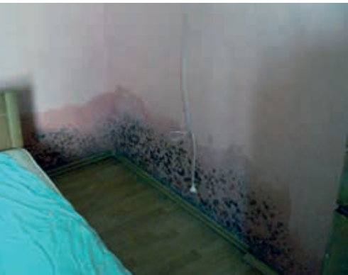
Nedostatečné nebo nesprávné vysoušení stavby vede k rozvoji a růstu plísní.
