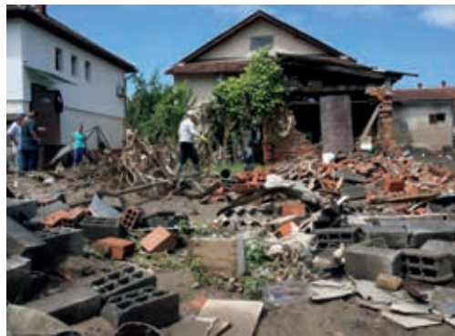
Drobné stavby jsou zvláště náchylné k poškození. Při jejich ohledání postupujte s největší opatrností, k jejich zřícení mnohdy stačí otevřít dveře.
