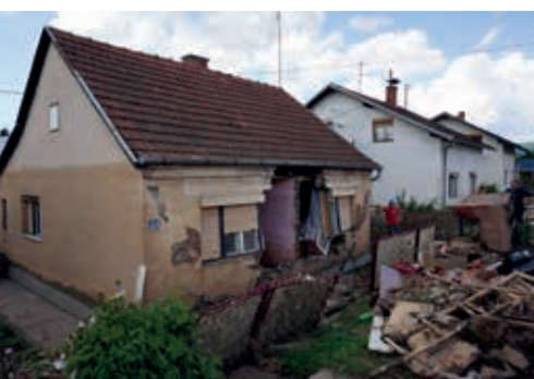
Před vstupem do porušeného domu se vždy poraďte s odborníkem, zda je dům bezpečný a nehrozí jeho zřícení.
