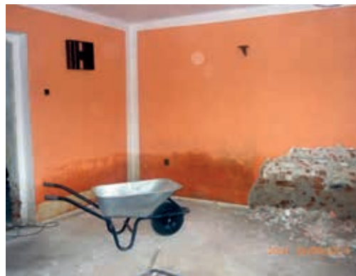
Pokud je omítka kontaminovaná znečištěnou vodou nebo odpadává, odstraňte ji do výše cca 20cm nad úroveň zatopení.
