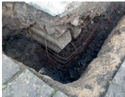
Porušené základy podbetonujte.
