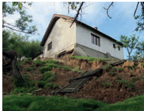
Přívalové srážky mohou způsobit podemletí základů.
